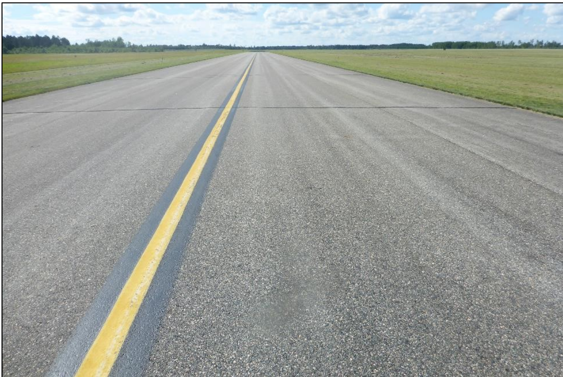
BJI PTA 002 (PCI = 88)
