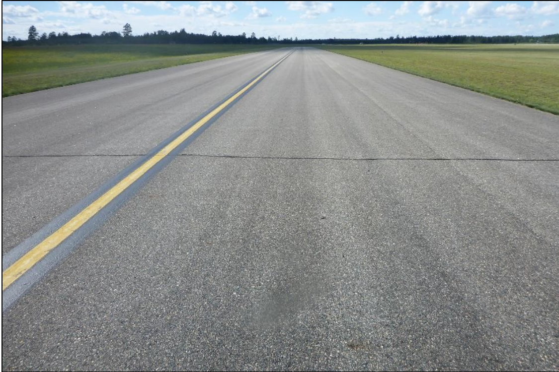
BJI PTA 001 (PCI = 93)
